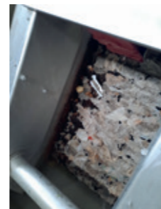
Aperçu du dégrilleur, après quelques heures seulement de fonctionnement.
